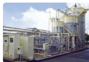
バイオマス発電施設
