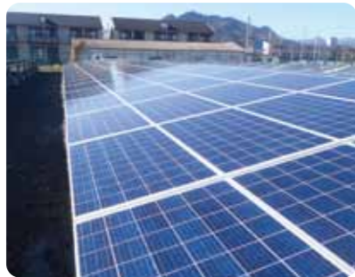
水上発電所(兵庫県丹波市)
