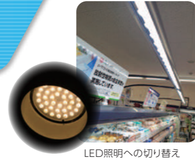
LED照明への切り替え
