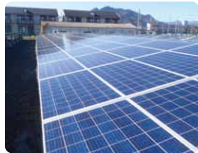
水上発電所（兵庫県丹波市）
