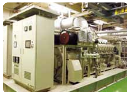
食品工場コージェネレーション設備
